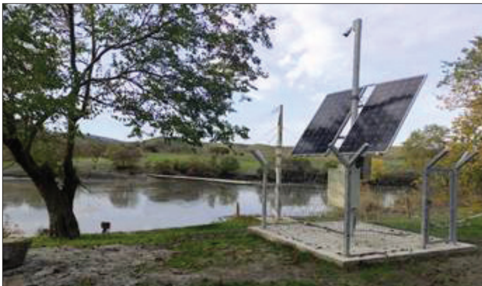
Şəkil 10. Avtomat hidroloji stansiya
